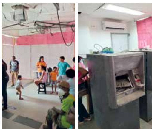
Agências do Bradesco danificadas por explosões
